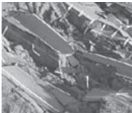
ズタズタに裂け関越自動車道
